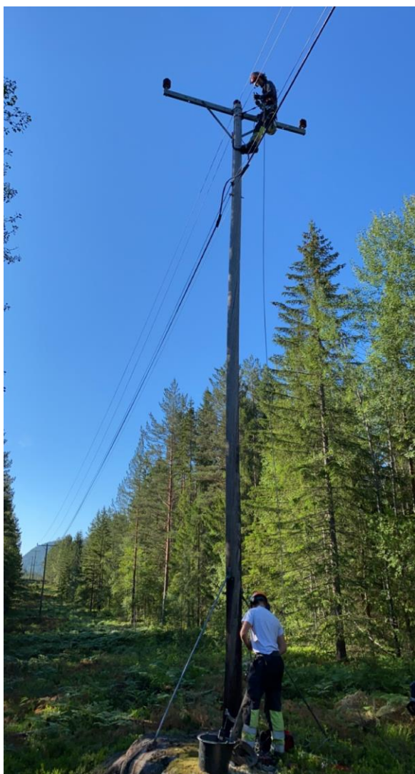
Oppdaget under årskontroll av høyspentlinjene.
