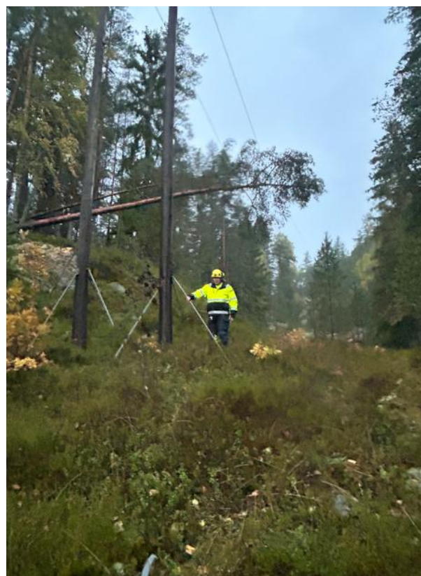
Tre på høyspentlinja i Brødsjø 4 oktober 2025.
