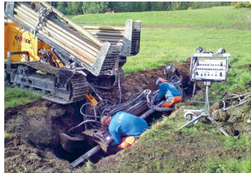
Fiberkryssing under jernbane ved Åre/Eggevåg Stasjon. Everkets arkiv.
