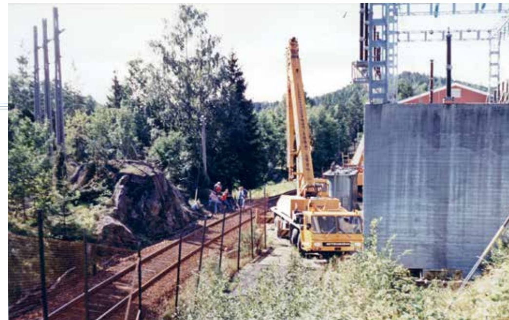
132/22 kV transformator flytta fra Holtane til Drangedal 18.8.1988. Everkets arkiv.
