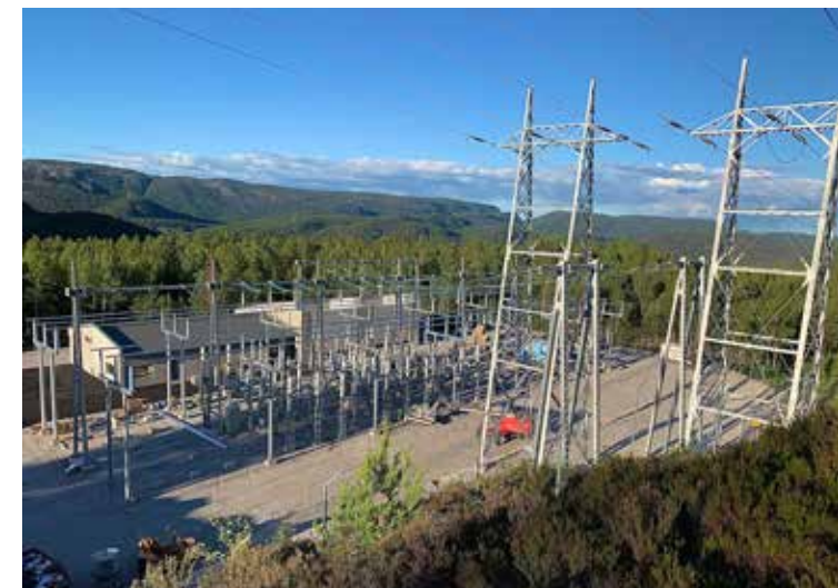
Tørdal Trafostasjon. Bildet er tatt sommeren 2020. Foto Runar Kleiv.
