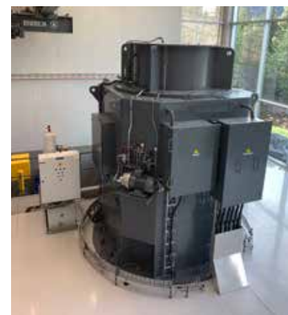
Generatoren i Nye Suvdøla. Everkets arkiv.
