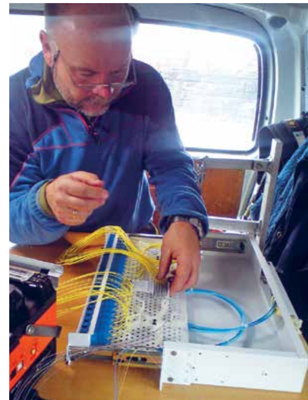
Magnar Austad, terminering av fiberkabel i fiberpanel i node. Everkets arkiv.
